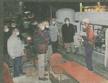
LPガスを燃料とした発電機を紹介するエネジンの担当者＝浜松市中区で
